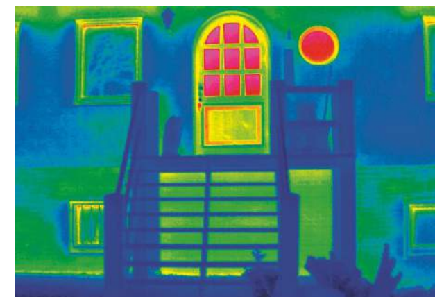
Wärmebilder decken Schwachstellen auf
