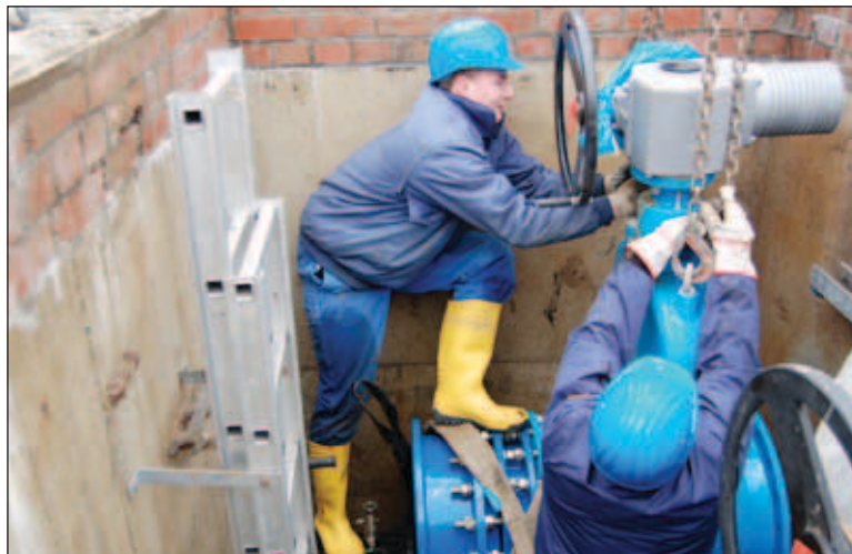
WAG-Mitarbeiter beim Austausch eines Absperschiebers auf der Druckerhöhungsstation auf dem Großen Dreesch. Ein Absperschieber hat die Aufgabe, bestimmte Leitungen - zum Beispiel auch während der Netzspülung - abzusperrern Foto: maxpress/mw
