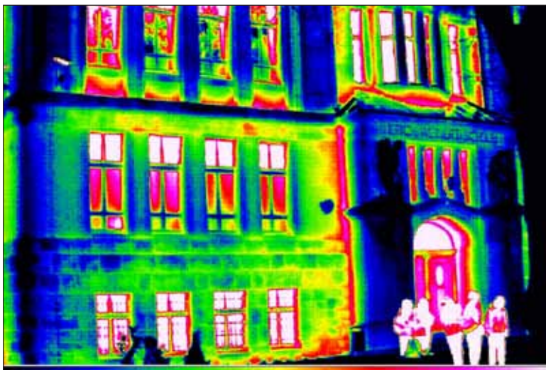
Auf dem Bild der Thermografiekamera ist deutlich erkennbar, wo das Gebäude Wärme verliert Foto: SWS
