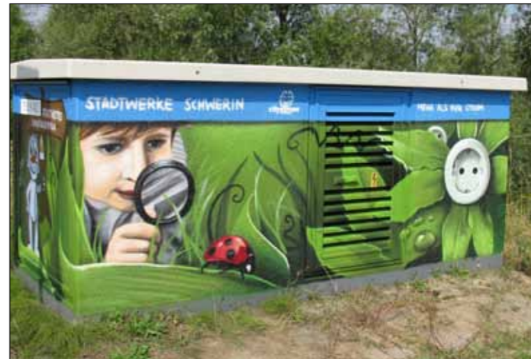
Wie hier in der Grabenstraße werden mehr und mehr Trafostationen in der Landeshauptstadt mit künstlerischen Motiven gestaltet Foto: SWS
