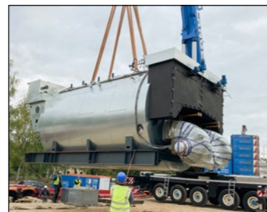
Mit Augenmaß und Armkraft wird der riesige Kessel zentimetergenau abgesetzt Fotos: Stadtwerke Schwerin
